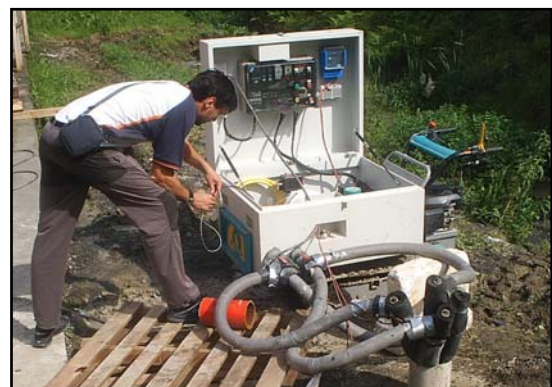
Imagen 2: Equipo de ensayo de respuesta geotérmica.
